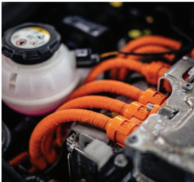
Kabler med høj spænding vil oftest være orange-farvede, som her i motorrummet
